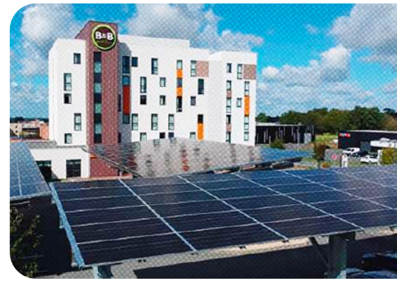
Panneaux solaires sur le B&B HOTEL Les Herbiers (France)
