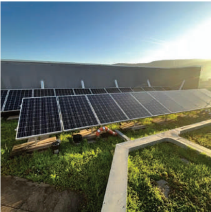
Panneaux solaires sur le B&B HOTEL Heidelberg (Allemagne)
